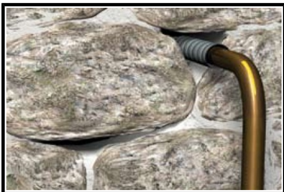
Situation initiale avant colmatage
