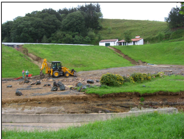
Saignées sur le talus aval
