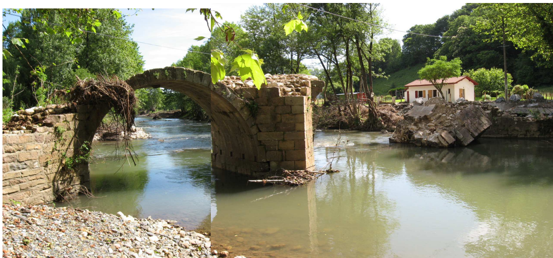
Dégâts au niveau du pont romain
